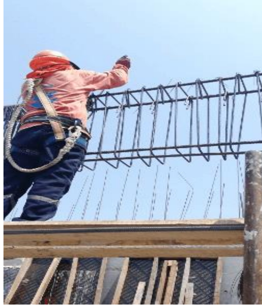
Figura 11: Trabajo en altura sin seguridad.
