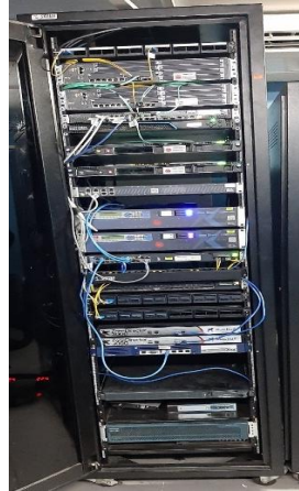
Figura 24. Servidor de la UP donde se encuentra instalado el Moodle Fuente: Unidad de Informática de la UP
