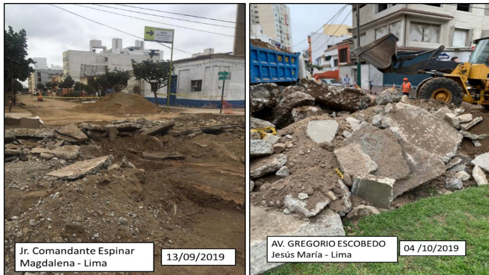
Figura 19: Fotografías de demolición de pavimento existente y corte a nivel de sub-rasante Fuente: Elaborado por los autores
