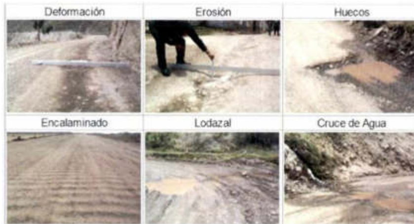
Figura 2.7 Tipos de daño en calzada no pavimentada
