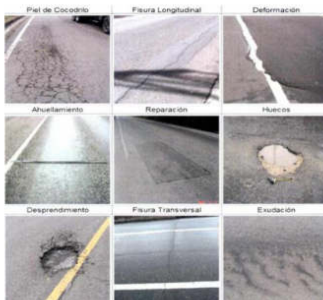
Figura 2.8 Tipos de daño en pavimento flexible
