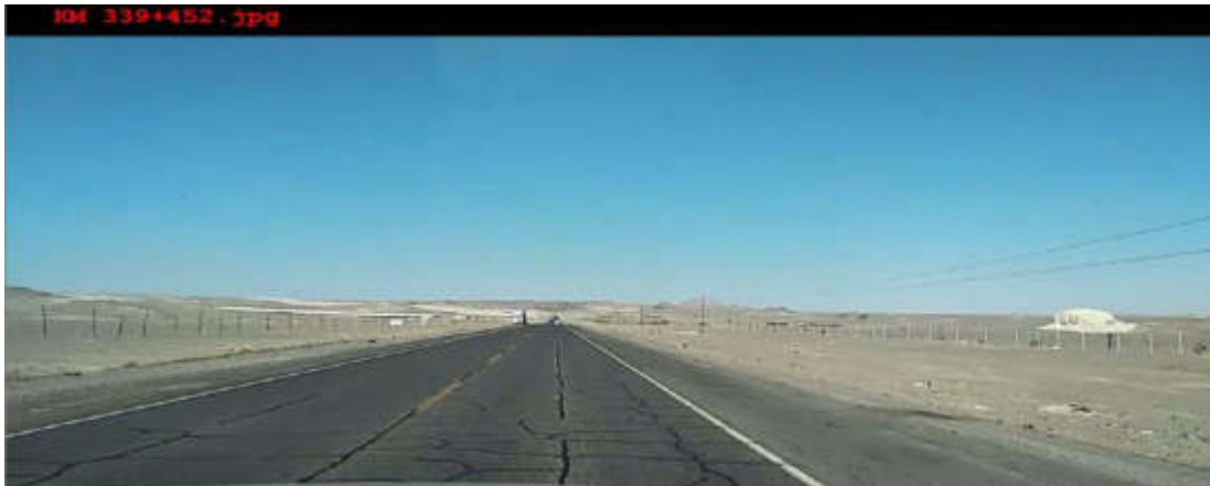
Tramo pavimentado Ica-Nazca. Grietas tipo piel de cocodrilo severas
