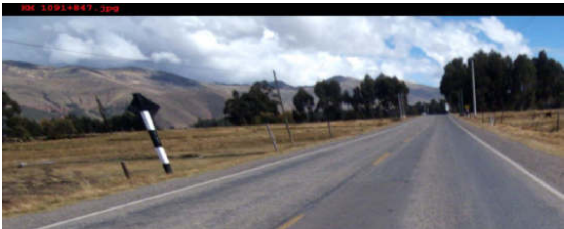
Tramo Sicuani-Combapata. Deformación por deficiencia estructural severa
