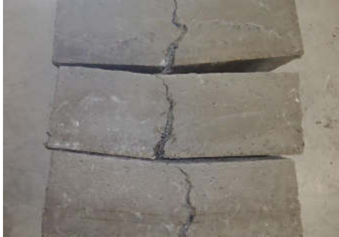
Figura N° 60: Grietas de las vigas al centro
