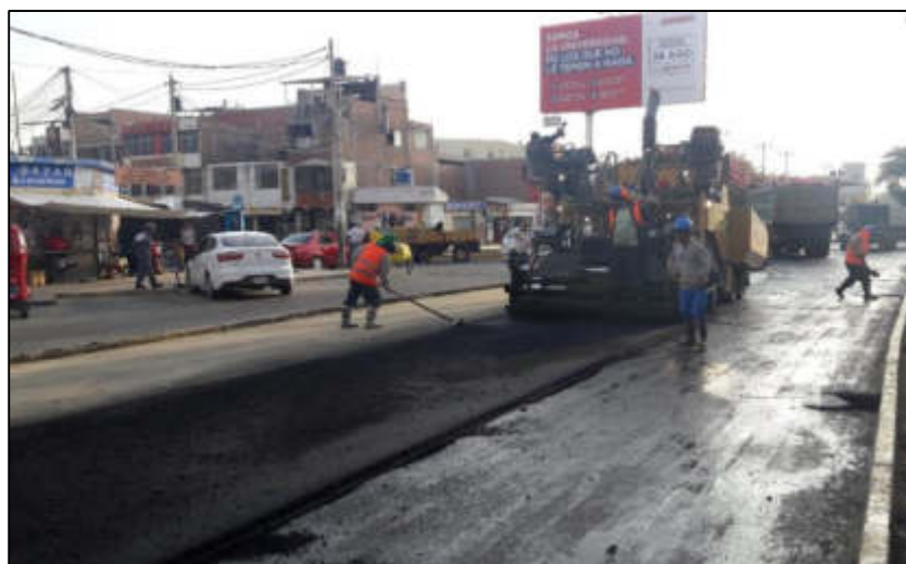
Figura 8. Uso incompleto de EPP –Obra 1
