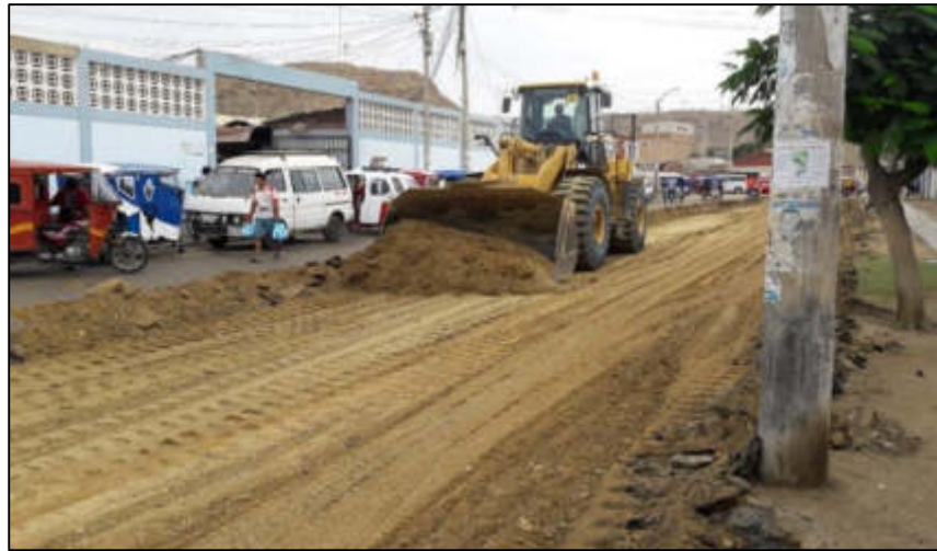
Figura 9. Falta de señalización –Obra 3
