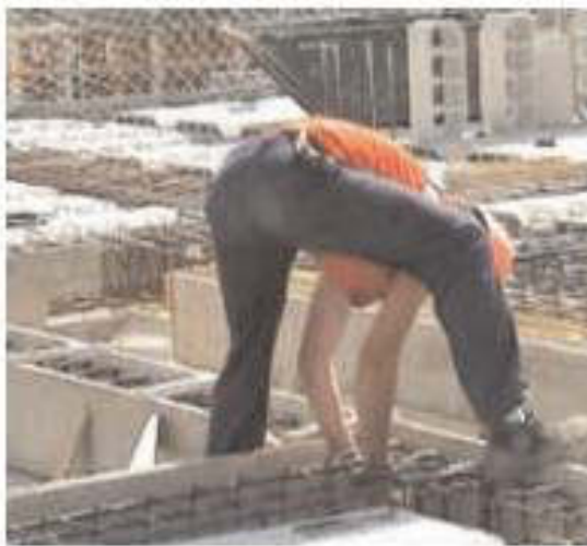
Figura N°136 Flexión inadecuada de la columna
