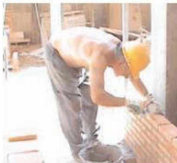
Figura N°134 Flexión inadecuada de la columna
