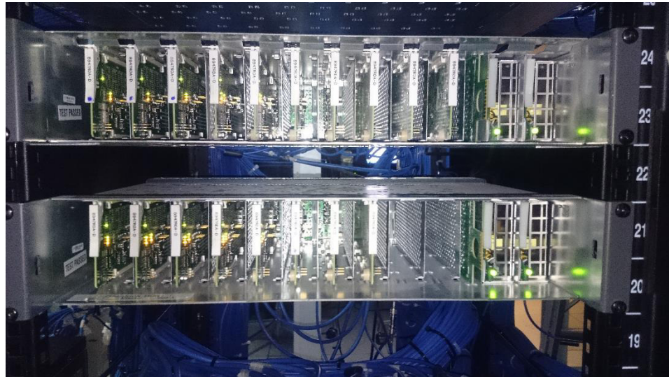
Figura 50. Vista interior de los cofres de distribución
