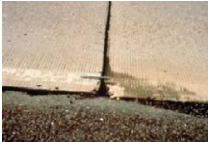
Figura 7: Escalonamiento en un pavimento rígido
