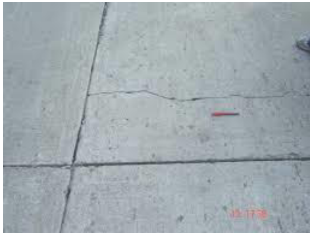
Figura 9. Agrietamiento transversal y longitudinal
