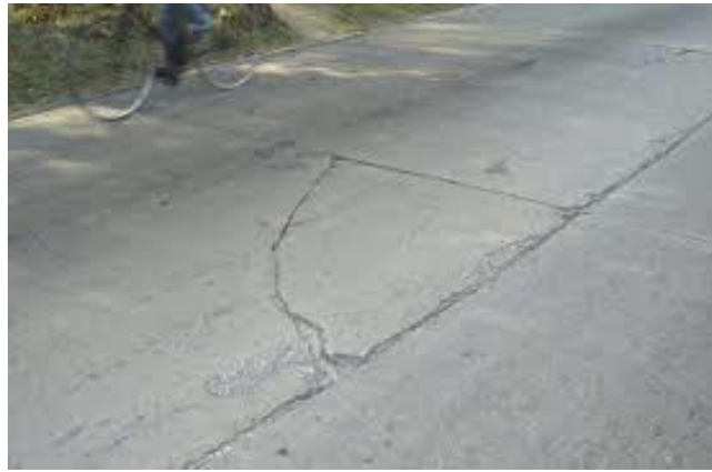
Figura 8. Agrietamiento en esquina
