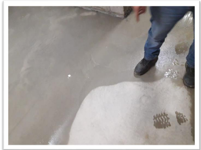
Foto 9: Losa de las tolvas de extracción – Edificio de Herbicidas
