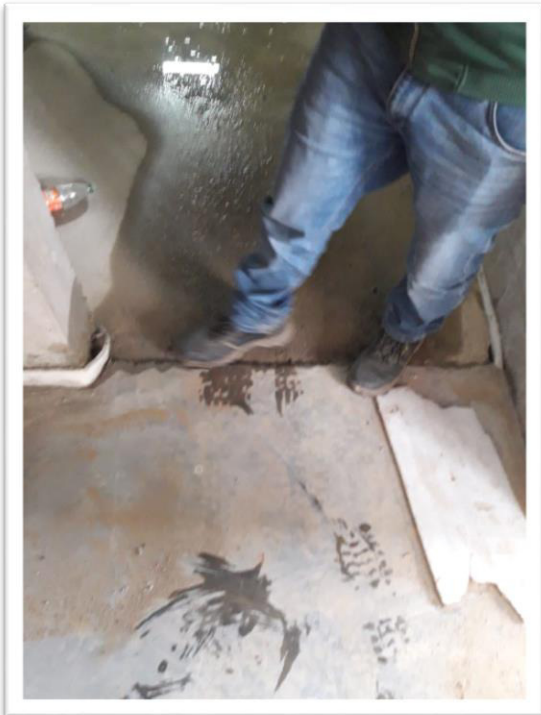
Foto 10: Losa de las tolvas de extracción – Edificio de Herbicidas
