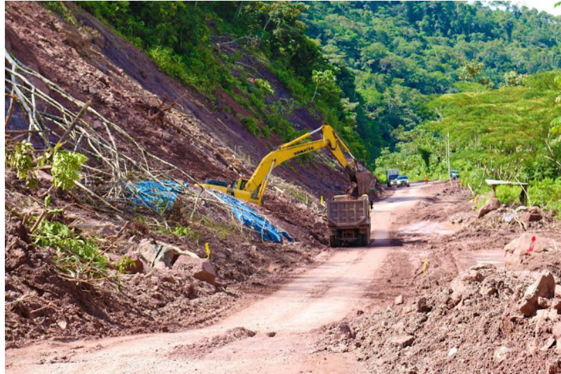
Imagen N° 1: Tramo sin asfaltar de la carretera Federico Basadre en Ucayali.
