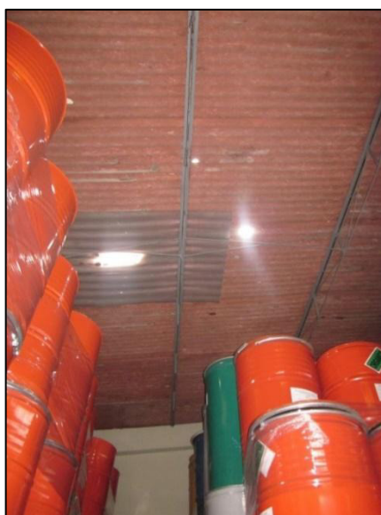
Figura 168 Techo de almacén de materia prima en mal estado
