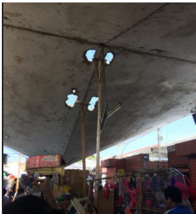
Fuente: Foto tomada al interior del Mercado – Estructura deteriorada y de alto riesgo
