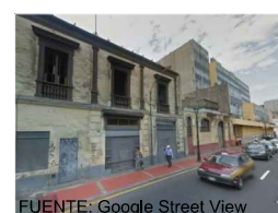
A espaldas de la catedral en el Jr. Lampa, muebles en estado calamitoso que han colapsado
