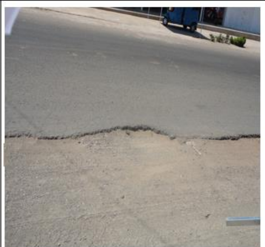
Desnivel carril berna
