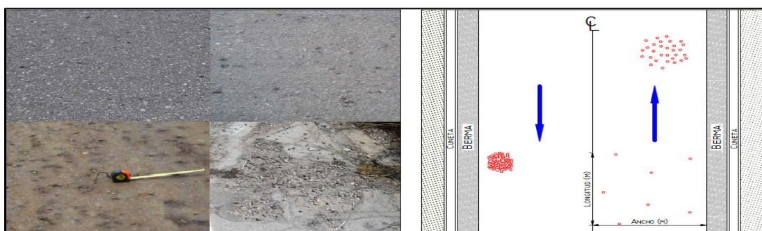
Figura 25: Desprendimiento de agregados. (DAG, unidad de medida: m 2 )
