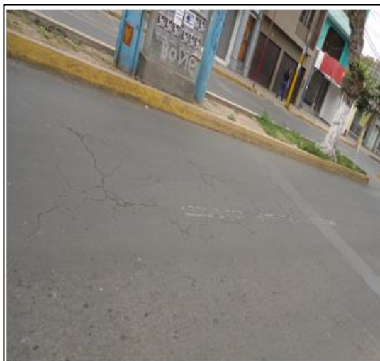
Agrietamiento en bloque
