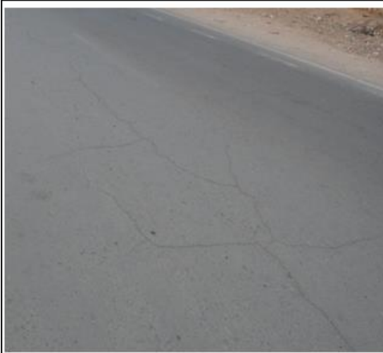
Agrietamiento en bloque
