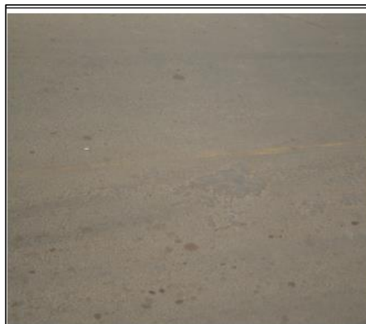
Desprendimiento de agregados
