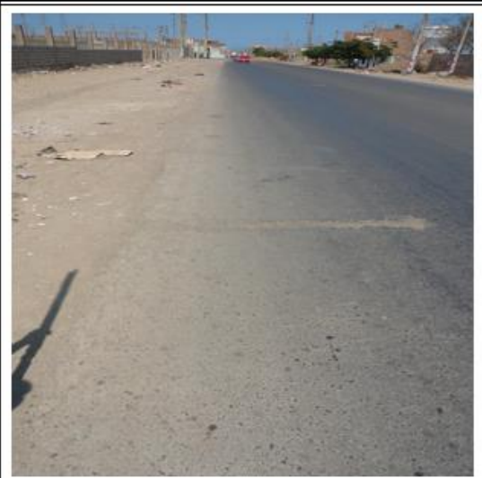
Grieta de reflexión junta
