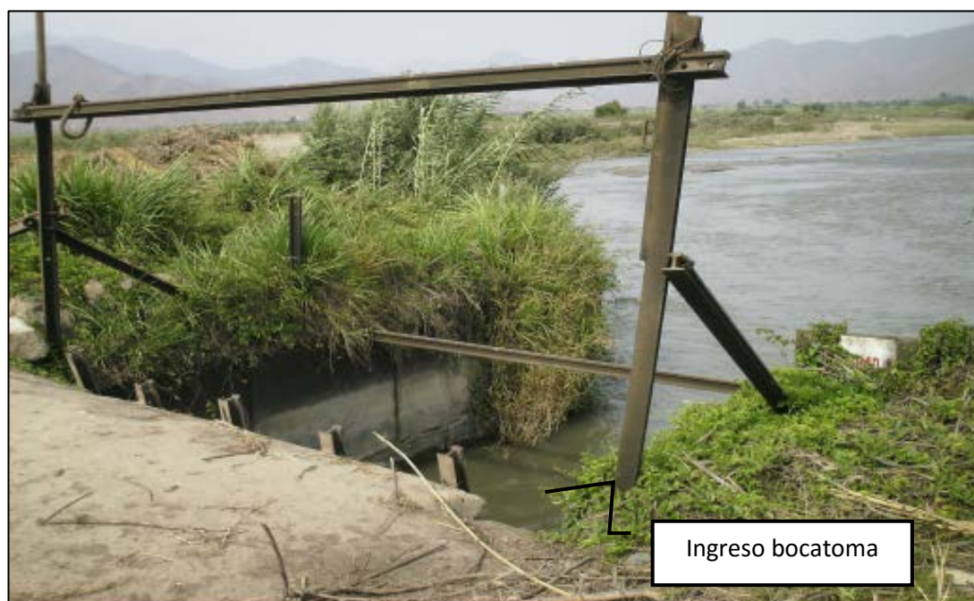
Figura 1 Ventana de ingreso al canal de conducción Elaboración: la autora
