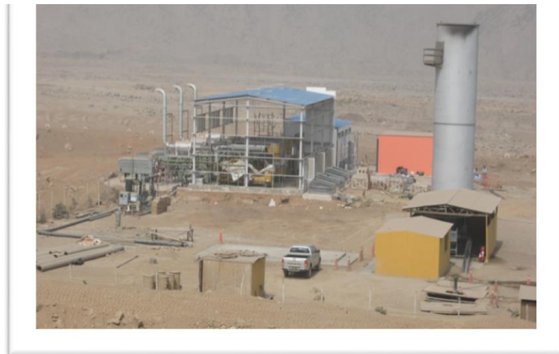
Planta eléctrica en Huaycoloro que se distribuye electricidad a través de su conexión con el SEIN (Sistema Eléctrico Interconectado Nacional)
