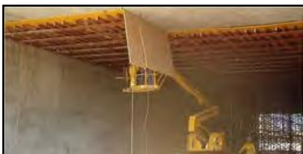
Ilustración 6: Paneles de encofrado adheridos al concreto.
