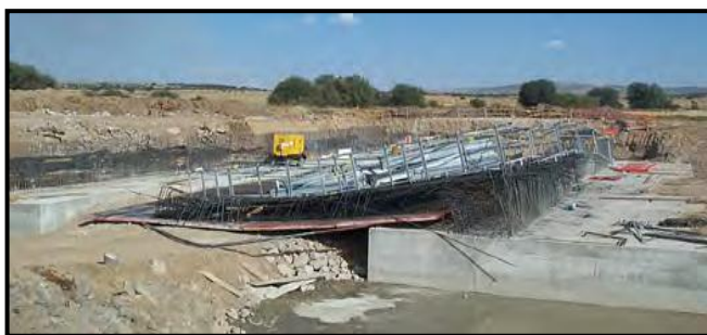
Ilustración 7: Desplome de encofrado y armadura con andamio en ejecución de muro.
