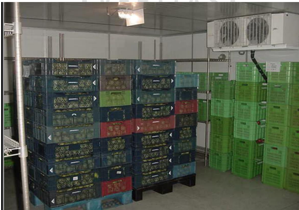
Figura N° 20: interior de cámaras frías. Fuente: Internet
