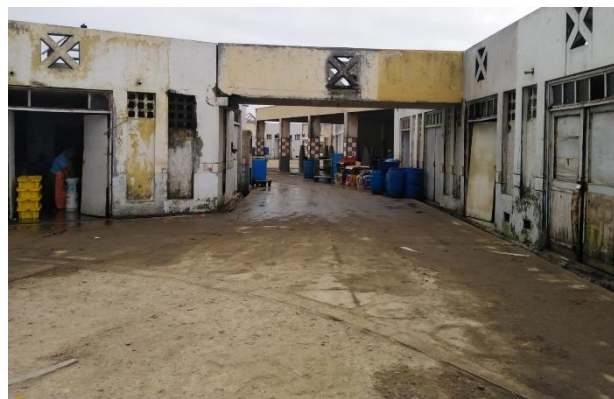
Figura 47: Infraestructura inadecuada – CEPPAR. Fuente: Propia
