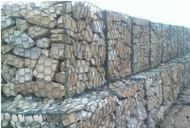
Figura 35. Gaviones de alambre.
