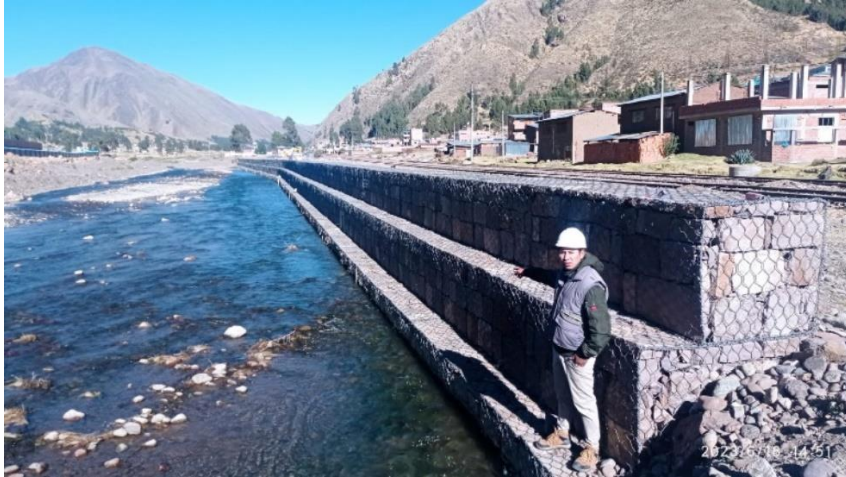
Figura 21. Muros de gaviones como defensa ribereña.
