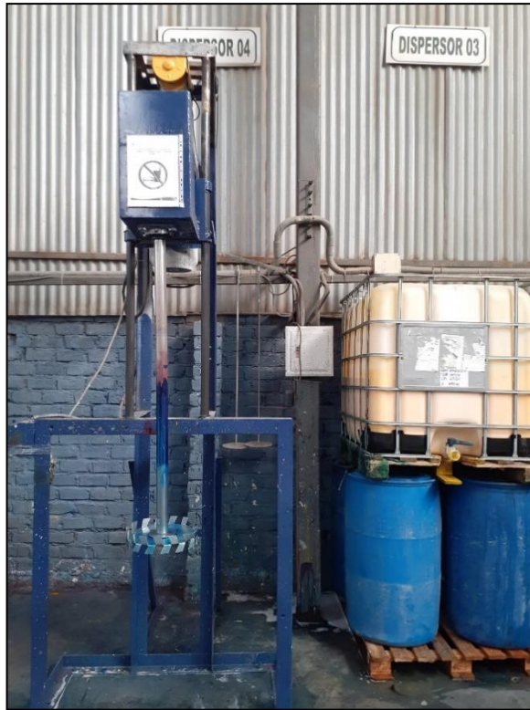
Figura 298. Máquina dispersora y tablero eléctrico – Velcar Perú
