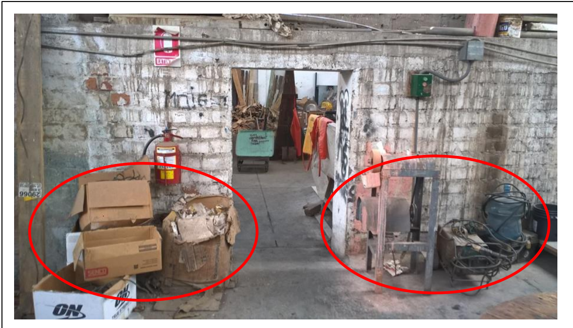
Imagen 5: Cajas de cartón y Equipos obstaculizando el paso
